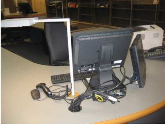
Figura 1: Los cables están ordenados y ligados.
