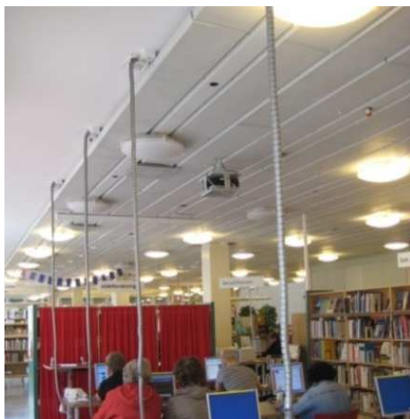
Figura 19: Los equipos se conectan a las canalizaciones que pasan por el techo.
