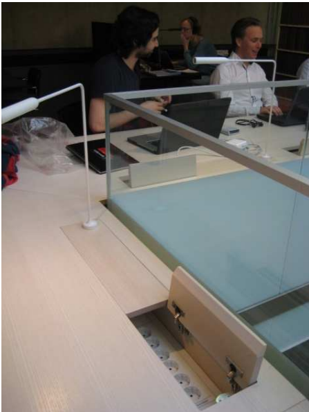
Figura 27: Las conexiones están en el espacio de trabajo, protegidas y sin ningún cable a la vista.
